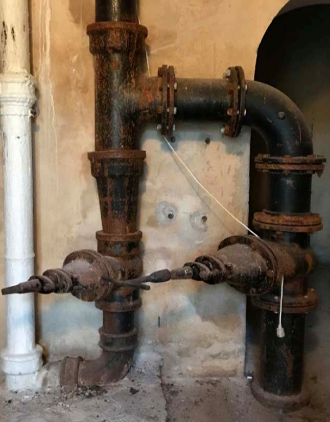
Billdokumentation från vattentornet: rörledning och trappa. Foto: Ann Magnusson.
